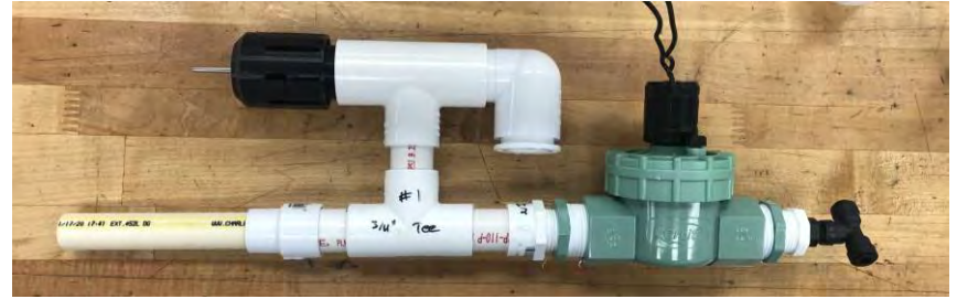
Vanne de surpression installée
